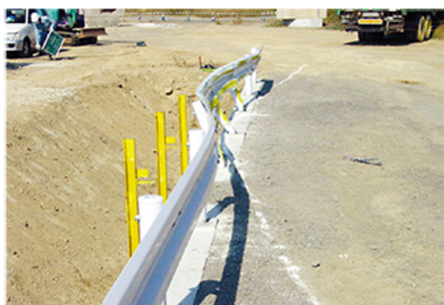
衝突後の状況（直接基礎上）
