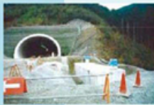
トンネル洗浄用水槽
