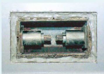
定着状況 (中間ボックス定着部)
