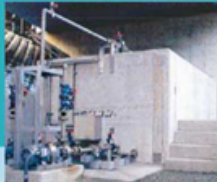
融雪水回収槽
